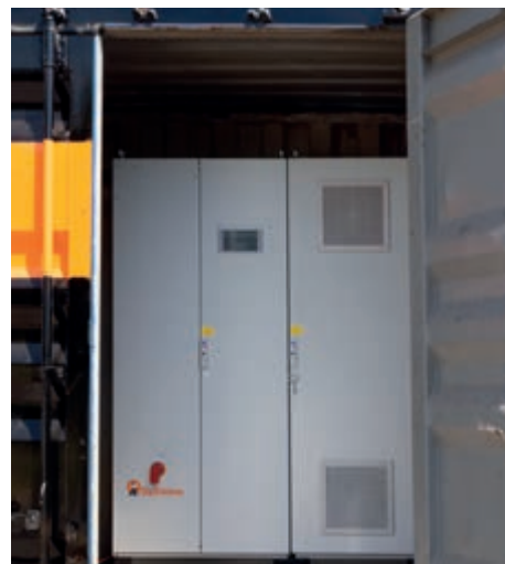
Schaltschrank zur vollautomatischen Steuerung
